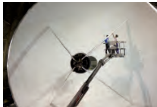
Les spécialistes procèdent ici dans le hangar (au fond, ci-dessus) à l'entretien et aux réparations d'une antenne.
