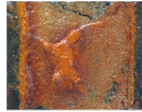
rouille sur matériau corrodé
