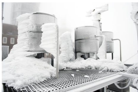
Système d'aspiration de l'air extérieur sur le toit du chalet du Puy de Dôme
