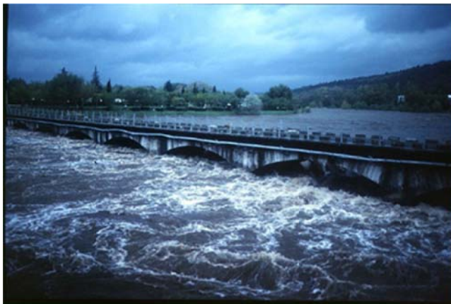
Crue de l'Ardèche - 20 octobre 2001 : Le pont de Sampzon © Michel Lang (IRSTEA).
