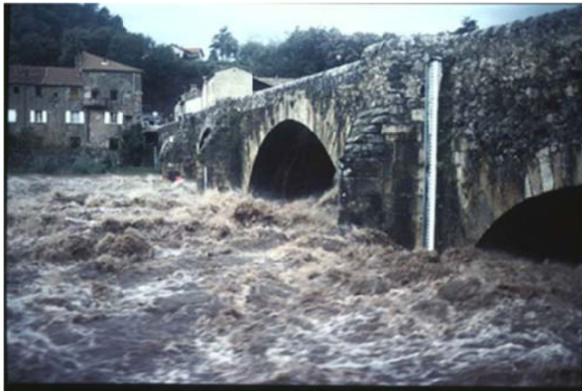
Crue de l'Ardèche – 20 octobre 2001 : Pont-de-Labeaume © Michel Lang (IRSTEA).
